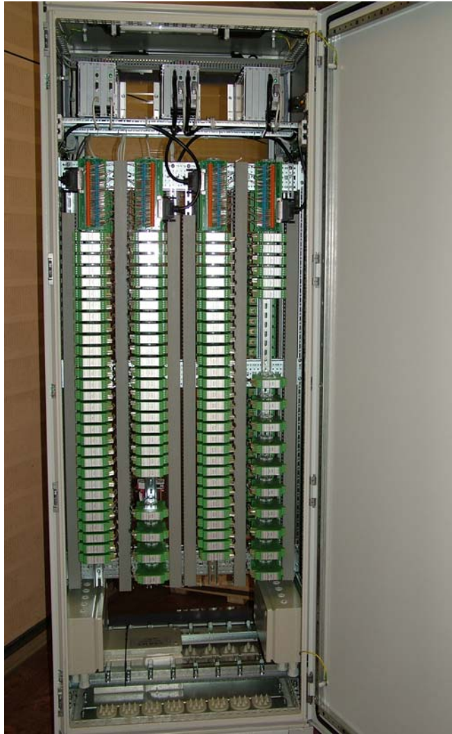
Рис. 1 Стойка системная в сборе.
